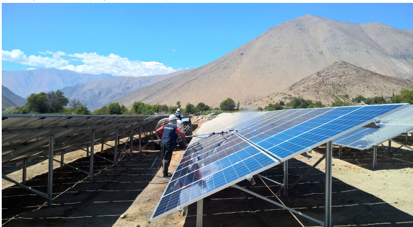
Parque Solar Sol Del Norte/Parque Solar Luna Del Norte, Chile.
